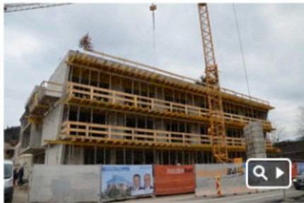
Im September 2014 soll der Bau fertiggestellt sein. Dieser moderne Trakt wird dann u.a. 14 barrierefreie Zimmer beherbergen. (Foto: ofp.kommunikation)
