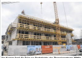
Vor Kurzem fand die Feiler zur Dachgleiche des Therapiezentrums Wittlinger in Walchsee statt. Foto: ofp kommunikation
